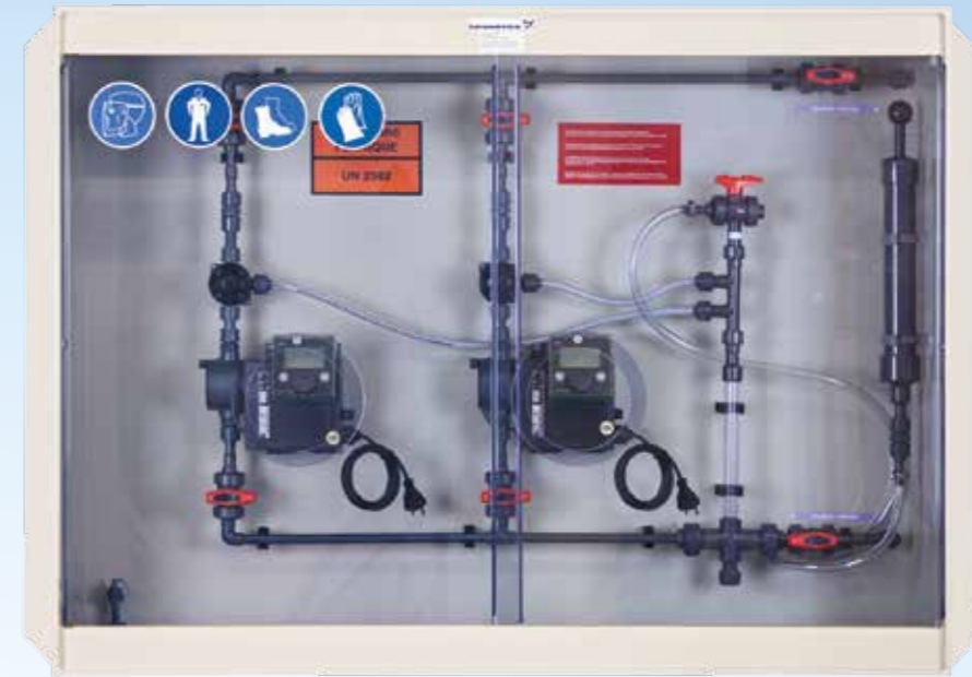
Skiduri de dozare montate în cabinet
