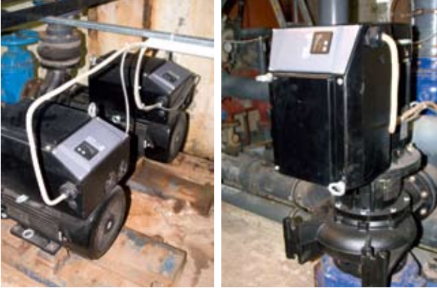
Drehzahlregelbare Blockpumpen NBE im Wasseraufbereitungs-Kreislauf des Multifunktionsbeckens (links) und im Wildwasserkanal (rechts).
